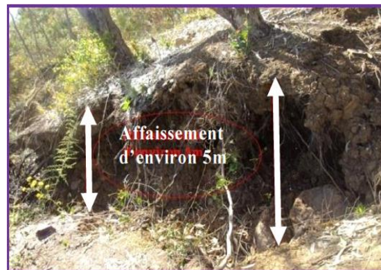
Figure 1 : Désordres montrant un affaissement d'environ 5 m.
