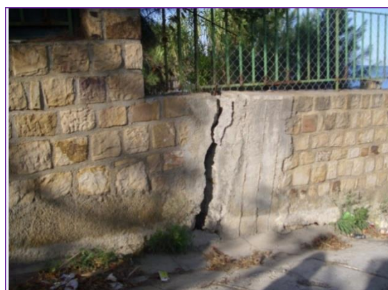
Figure 3 : Fissuration d'un mur de clôture.
