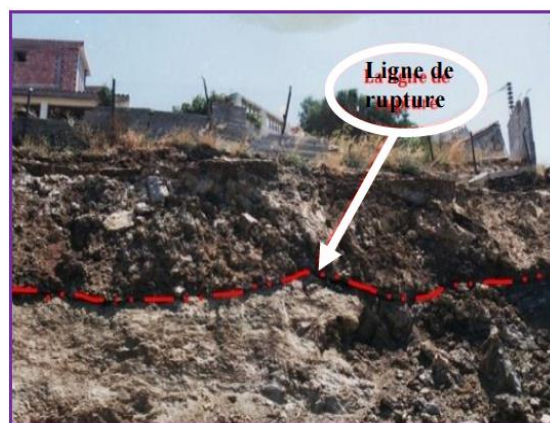
Figure 2 : Désordres montrant la surface de rupture.
