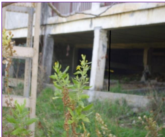
Figure 4 : Inclinaison et basculement d'une structure et fissuration des poteaux. Figure 4: Inclination and tilting of a structure and cracking of columns
